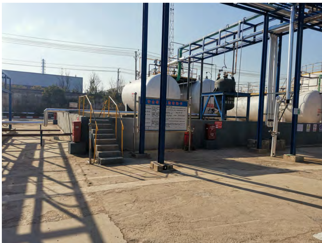
罐区围堰及附属应急设备
