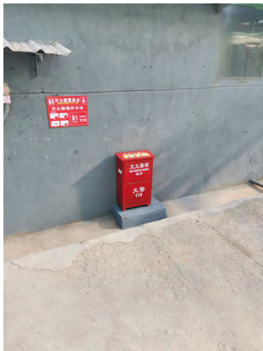
液氯罐区应急物资
