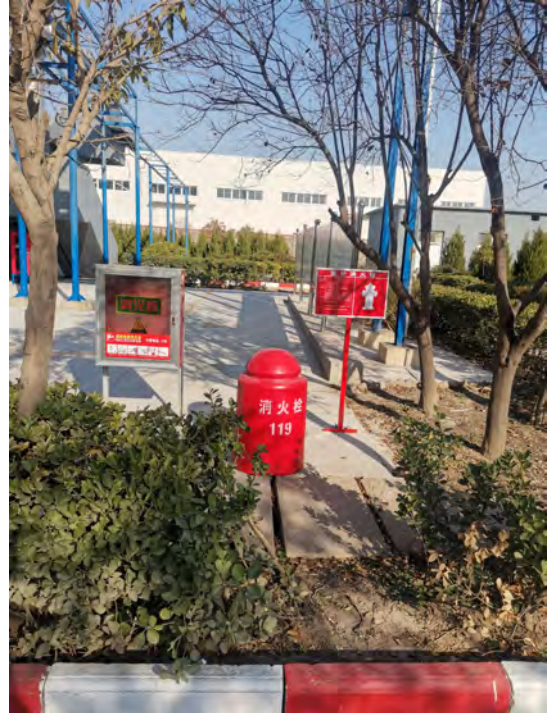
现场消防设备
