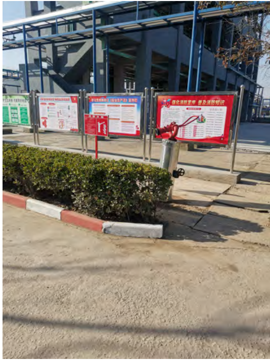
现场消防设备
